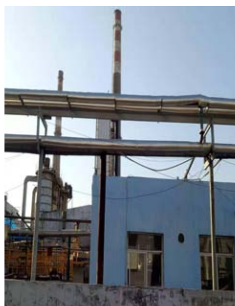
焦化厂污水处理站设施
