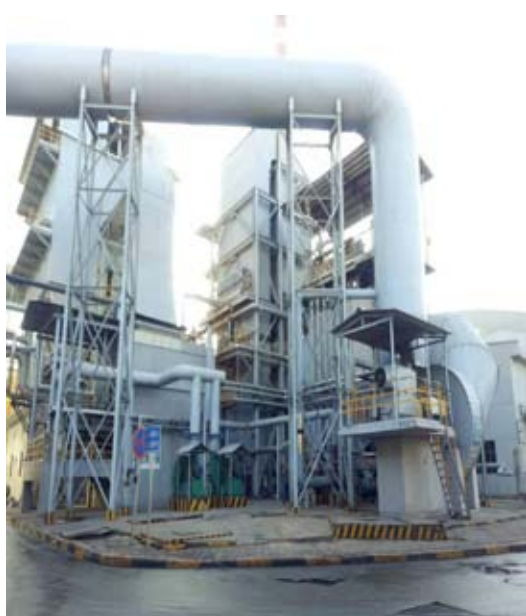
焦炉烟气脱硫脱硝设施
