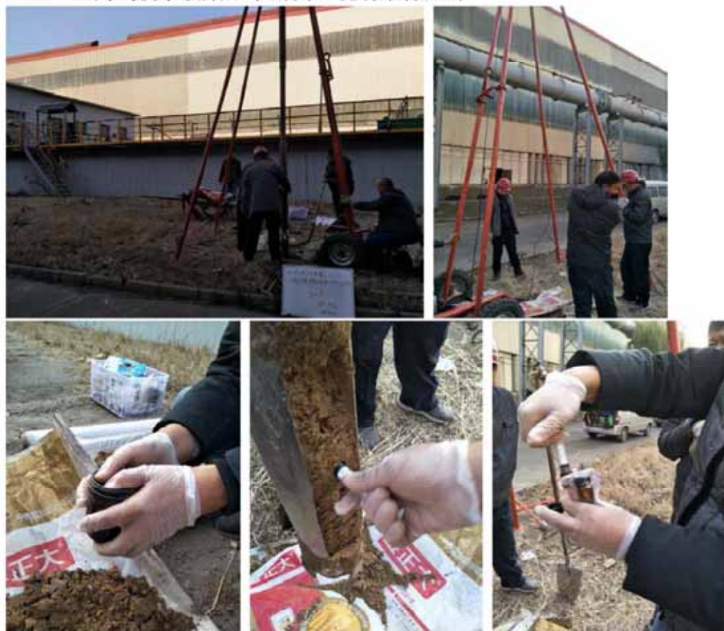
S6-9（五高线废水收集池东南侧）现场采样照片：
