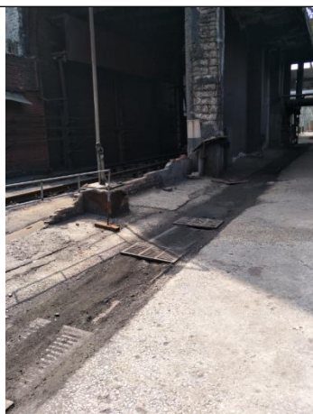
原湿熄焦塔，地面有煤尘
